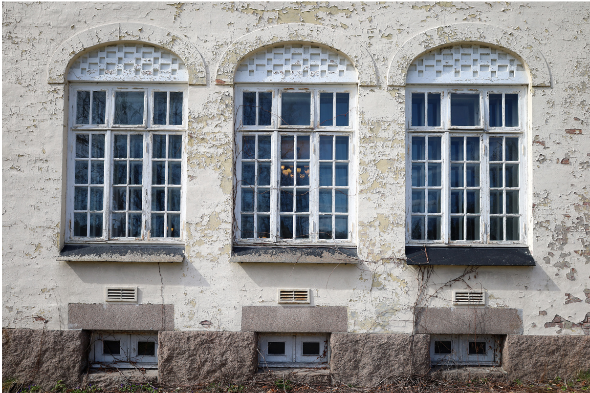
Fasaden med murpuss som flasser av.
